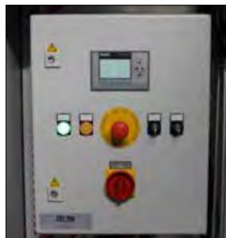
Steuerung mit Not-Aus. Logo mit Betriebs- & Störungsanzeige
