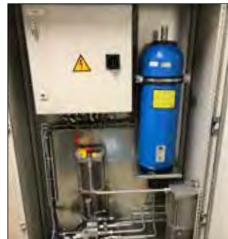
Blasenspeicher (stromunabhängiges Öffnungssystem)
