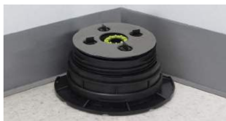
2. Das Stelzlager zusammenbauen und die beiden abgeschnittenen Seiten in der Ecke positionieren.
