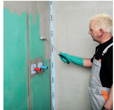
Nachdem die Details ausgebildet wurden, erfolgt die Flächenabdichtung mit dem jeweiligen Abdichtungsmaterial.
